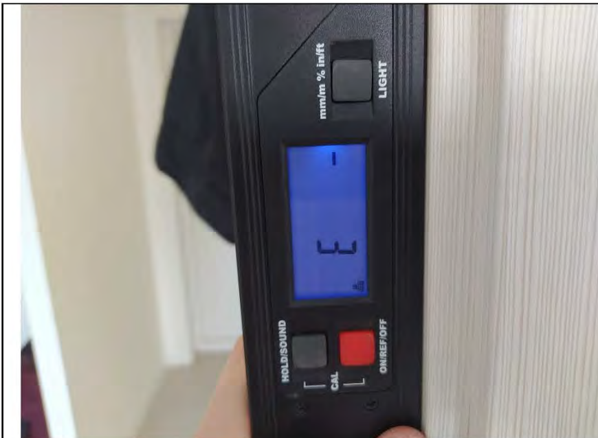
Фото №46. Отклонение коробки дверного блока в спальне.
