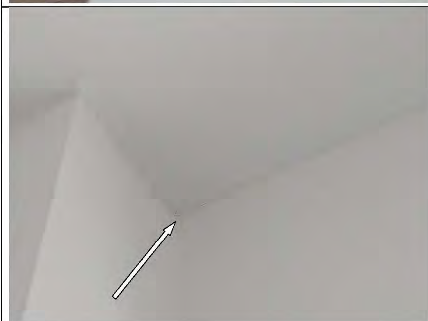
Фото №75. Дефект монтажа декоративного молдинга натяжного потолка в гостиной.
