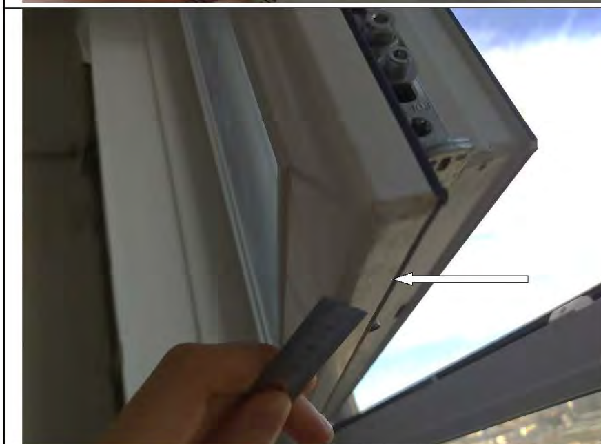
Фото №27. Профиль ПВХ оконного блока в спальне имеет дефекты (сколы).
