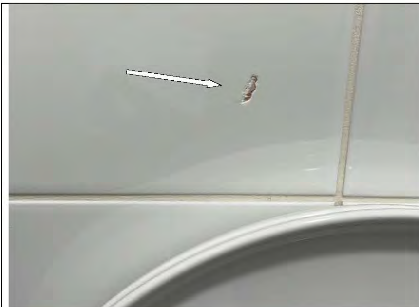
Фото №67. Скол на настенной керамической плитке в санузле.
