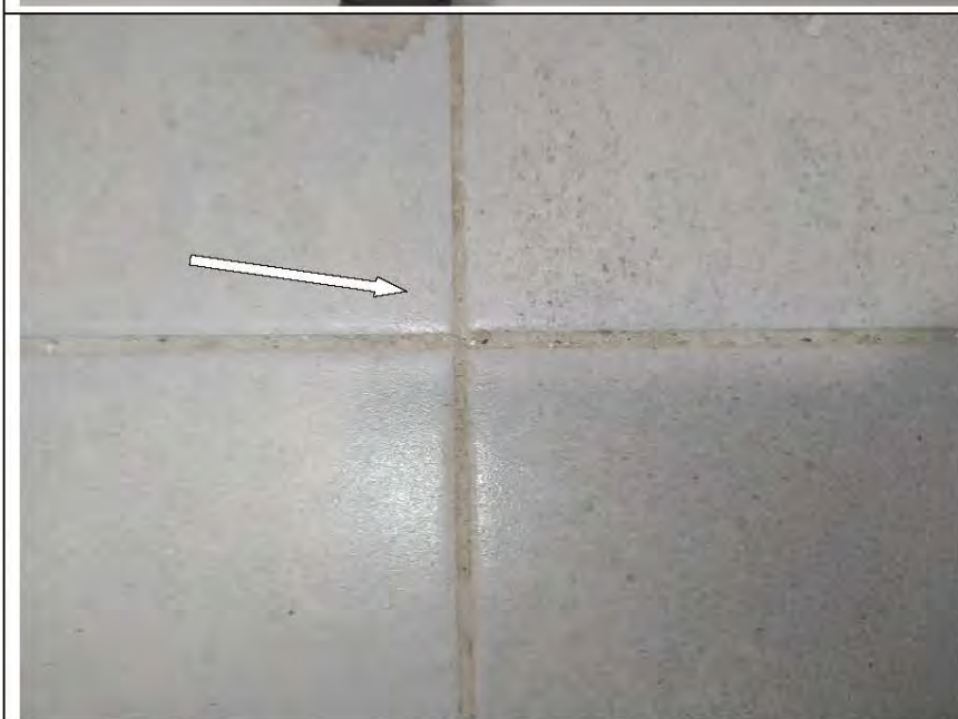
Фото №69. Затирка напольной плитки выполнена с нарушениями в санузле: разность ширины шва
