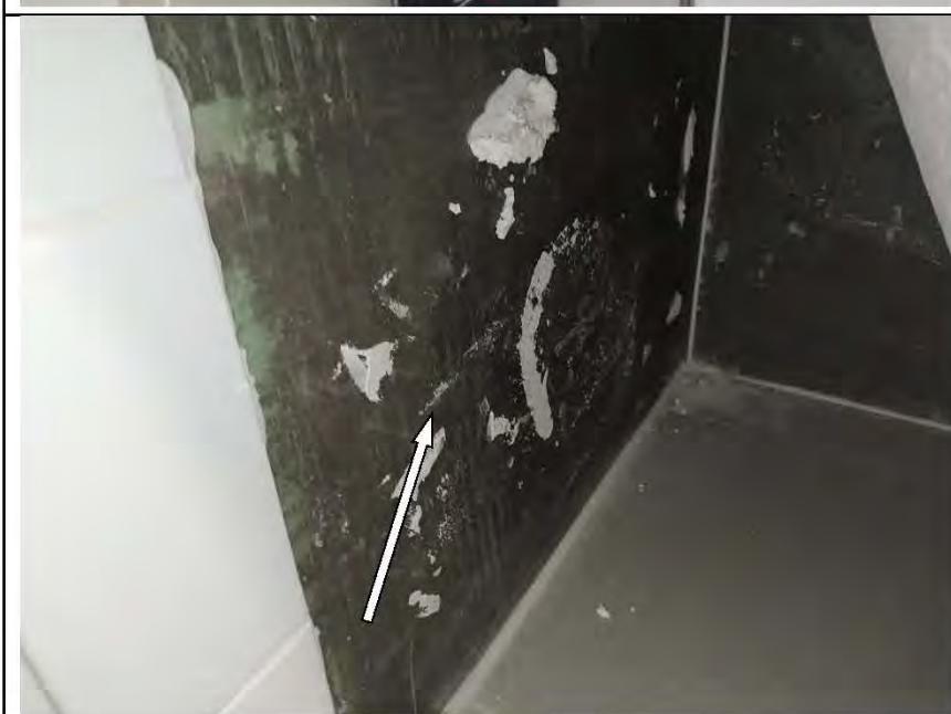
Фото №84. Частично отсутствует настенная керамическая плитка за ванной.
