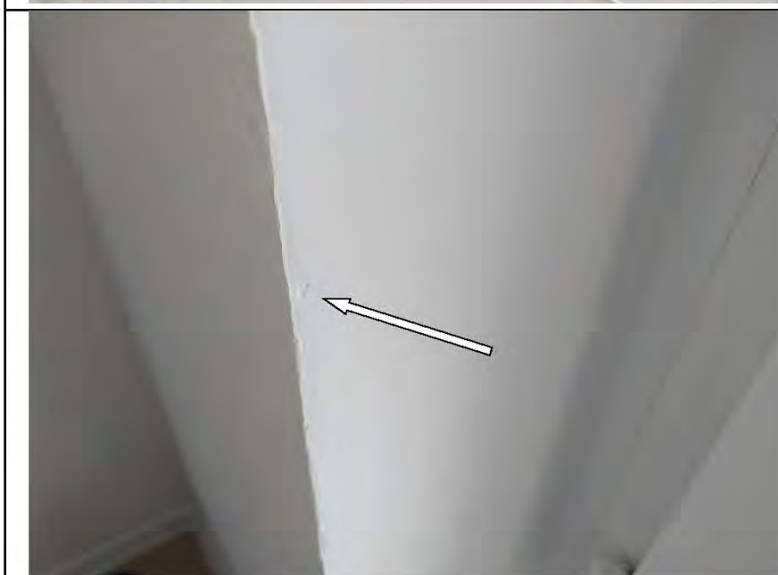
Фото №20. Окрашенные откосы оконного блока в кухне выполнены с дефектами (раковины).
