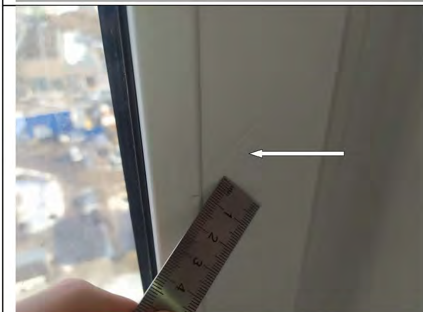
Фото №26. Профиль ПВХ оконного блока в спальне имеет дефекты (механическое повреждение).
