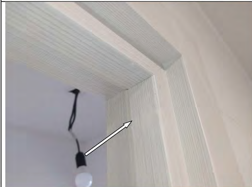
Фото №53. Коробка деревянного дверного блока в ванной комнате имеет дефекты (загрязнение малярными составами).
