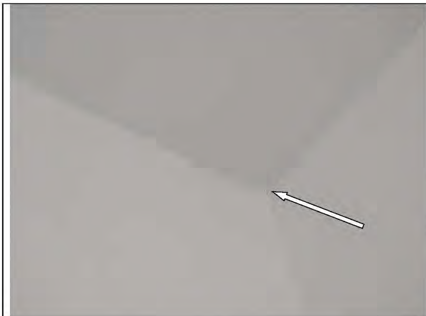
Фото №79. Дефект монтажа декоративного молдинга натяжного потолка в спальне.
