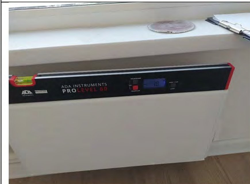
Фото №44. Отопительный прибор смонтирован неровно в спальне.
