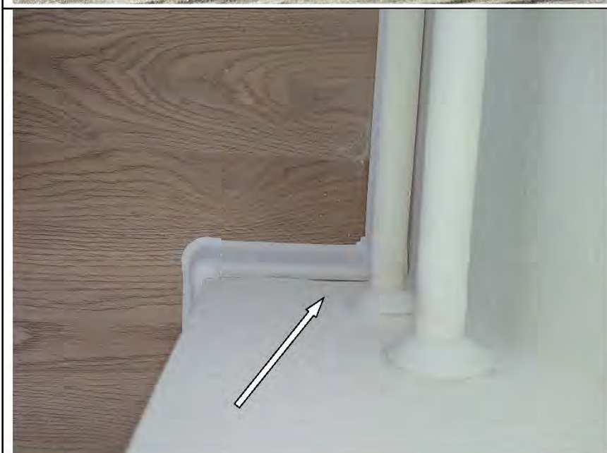
Фото №74. Напольный плинтус неплотно прилегает к стене (отходит), образуется зазор в кухне.
