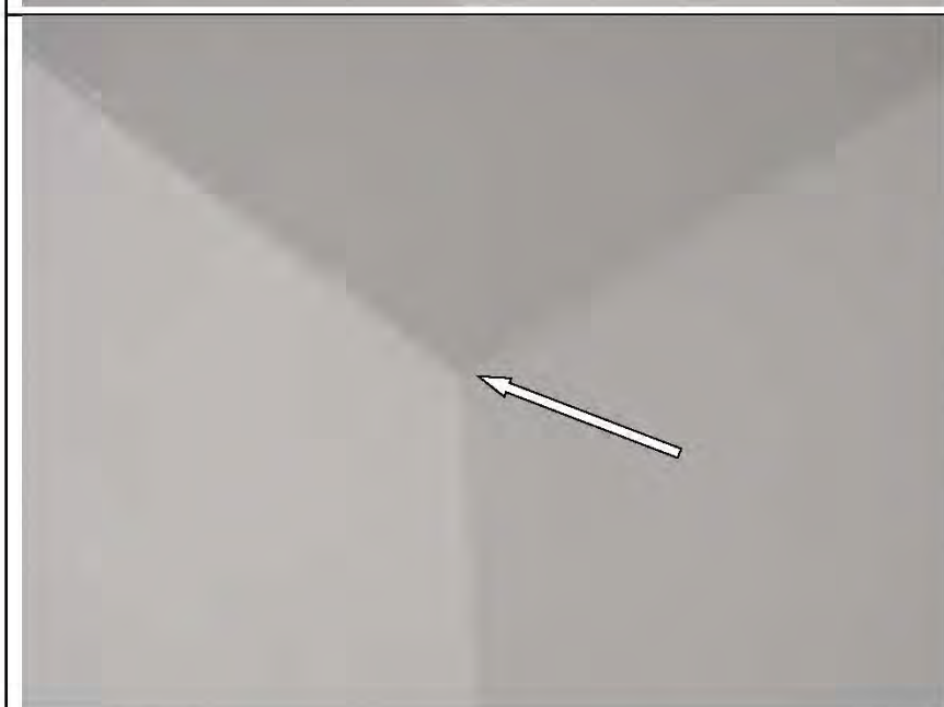
Фото №81. Дефект монтажа декоративного молдинга натяжного потолка в кухне.
