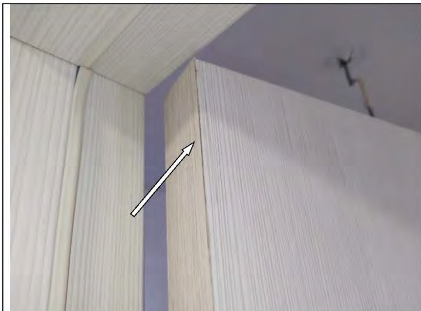
Фото №58. Дефекты (отслоение ламинации) на лицевой поверхности полотна деревянного дверного блока в ванной комнате.
