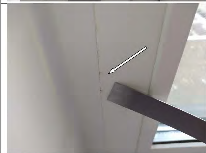
Фото №30. Профиль ПВХ оконного блока в гостиной имеет дефекты (сколы).
