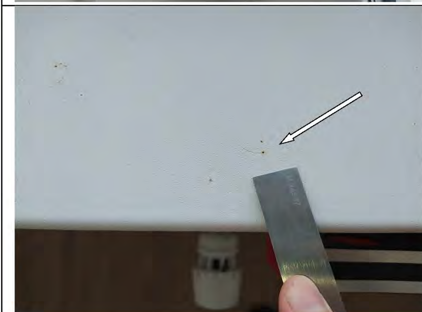
Фото №36. На лицевой поверхности подоконной доски в спальне имеются дефекты (царапины).
