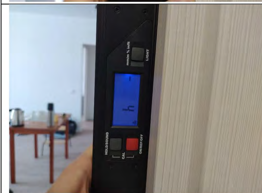
Фото №48. Отклонение коробки дверного блока в санузле.
