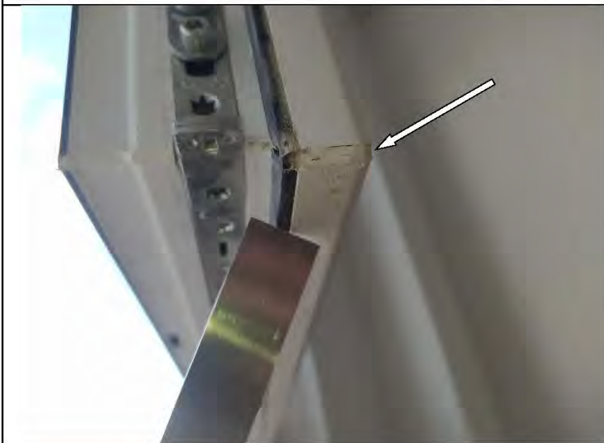
Фото №23. Профиль ПВХ оконного блока в кухне имеет дефекты (сколы).
