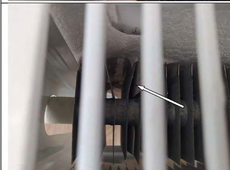
Фото №42. Радиатор в гостиной имеет дефекты (замятие)
